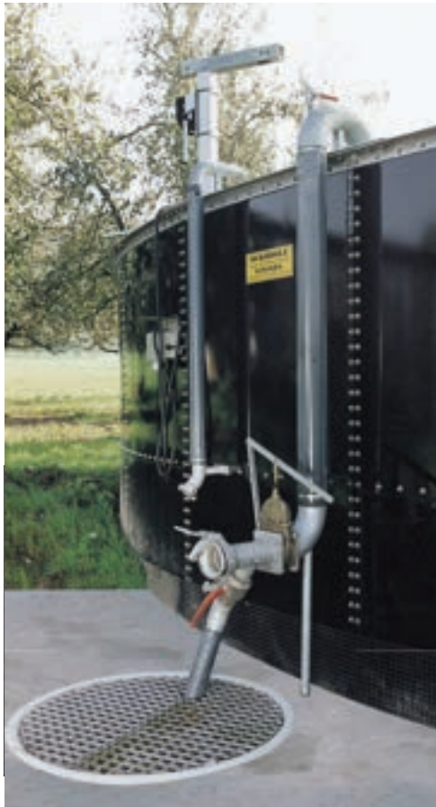
Conduite d'aspiration pour silo à lisier
